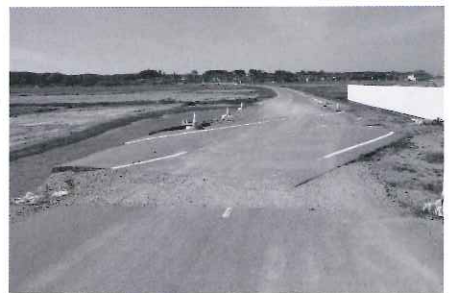
津波被害を受けた道路 2014年5月 (南相馬市)
