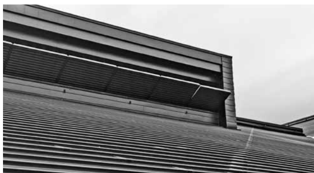
排煙窓開扉状況
