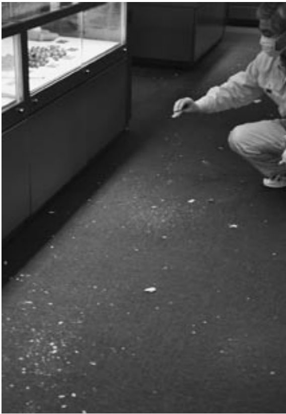
総合展示室天井から落下した プラスチック製破片の散乱状況
