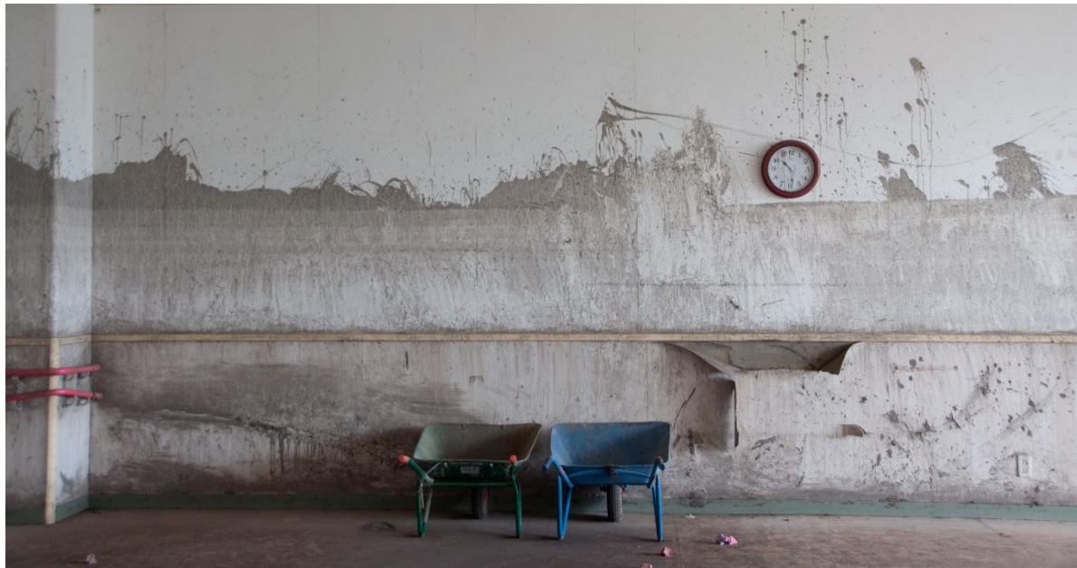
津波被災の跡が残る壁（南相馬市）
