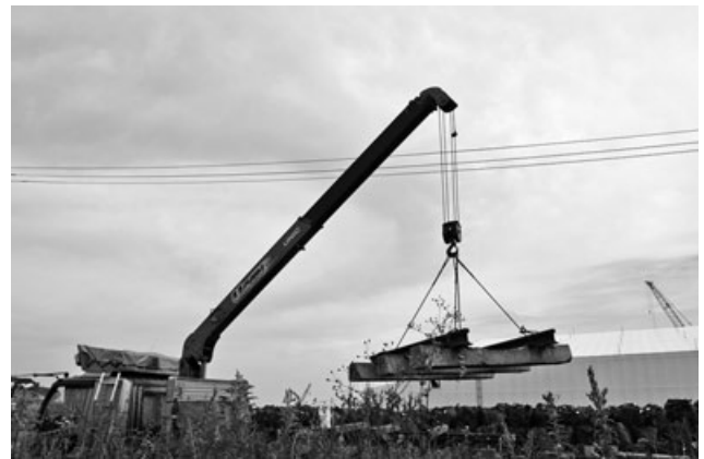
津波被災線路の保全（富岡町）
